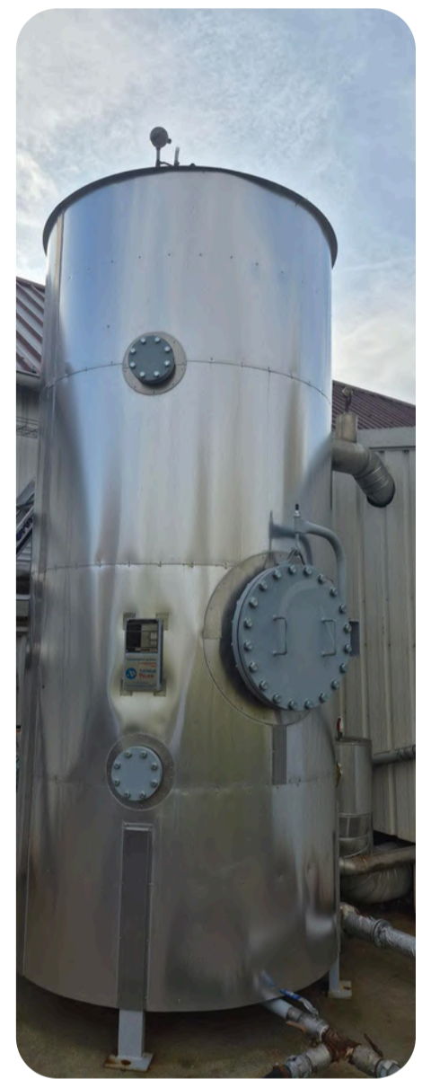
Cuve eau installée en 2025 Somater Mortagne
