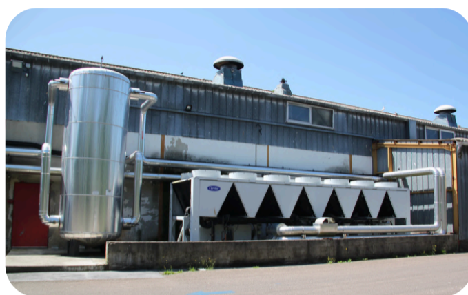
Système de récupération de chaleur
