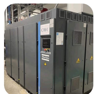
Nouveau compresseur - ANL Wellen
