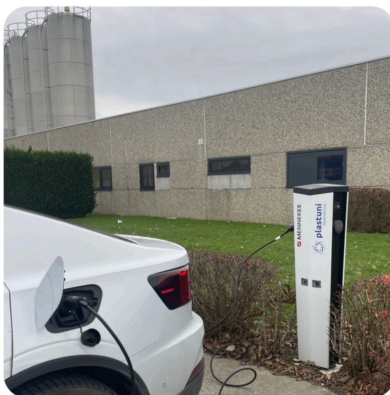
Bornes de recharges électrique - Plastuni Opérations
